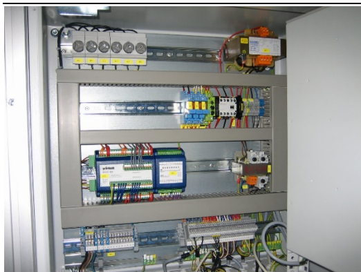
Abb. F-1 Schaltschrank
